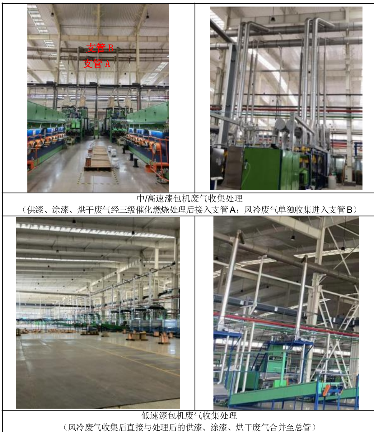
图 4.1-5 废气收集与治理设施照片
