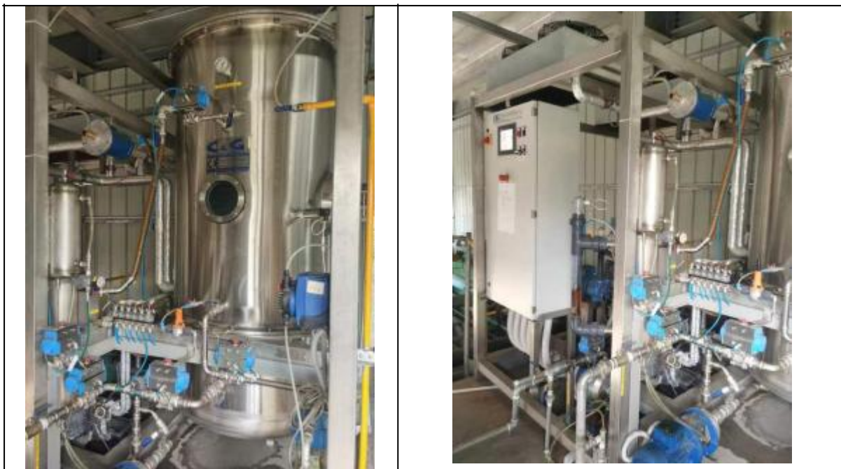
图 4.1-6 废水治理设施照片
